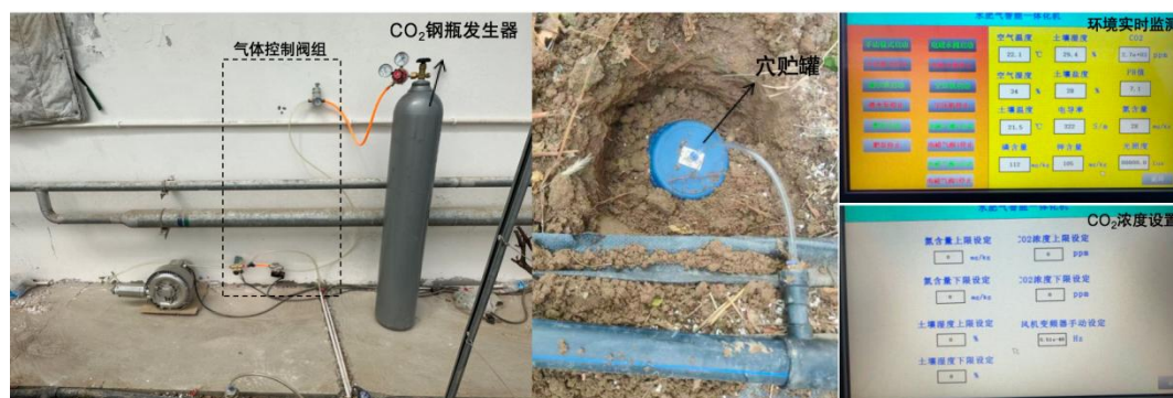
图 2-3 CO 2 钢瓶发生器、地下穴贮式灌溉管道和 CO 2 控制系统温室内实物图
